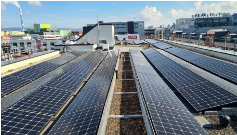
Abbildung 1: Neue PV-Anlage „EB4“ auf einem neuen Bürogebäude bei den Entsorgungsbetrieben
