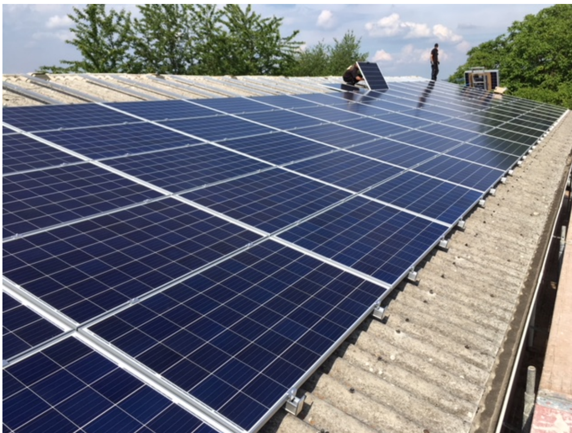
Abbildung 1: PV-Anlage 12: Illgen Ockenheim
